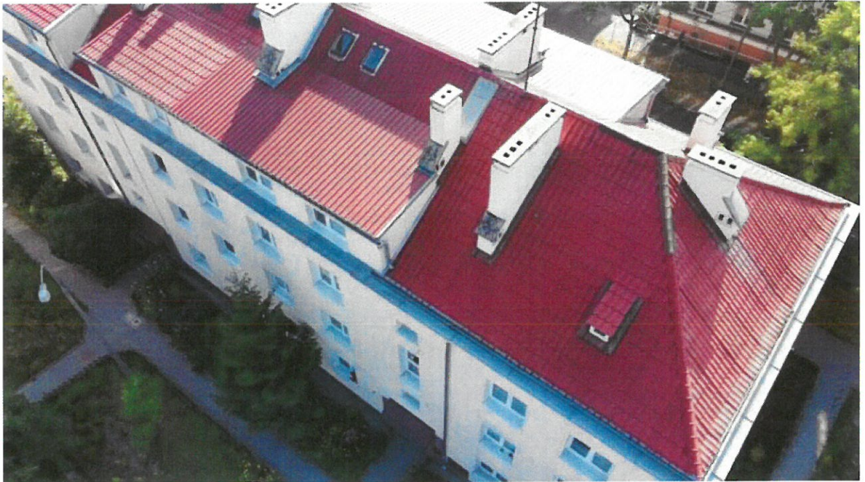
Pokrycie nad lokalem nr 19 i poddaszem (widok z góry od strony wejść do klatek)
