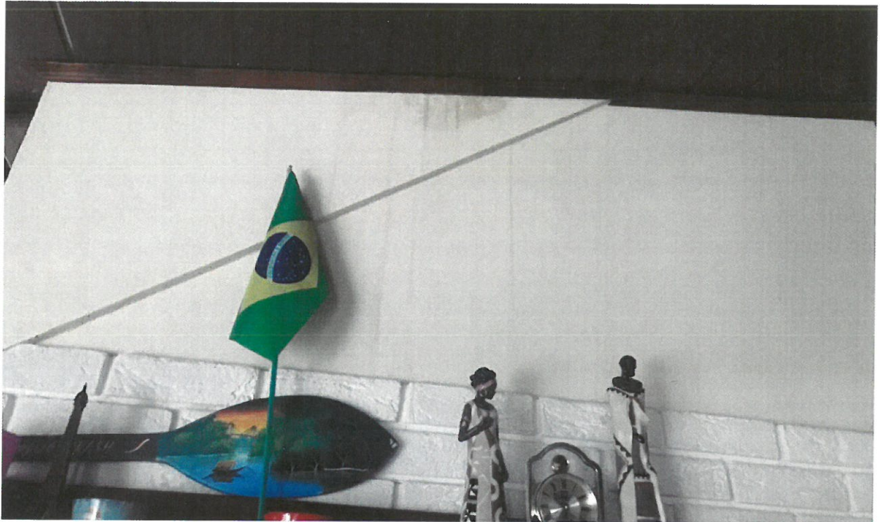
Zaciek w lokalu nr 19 (przy kominie nr 5)
