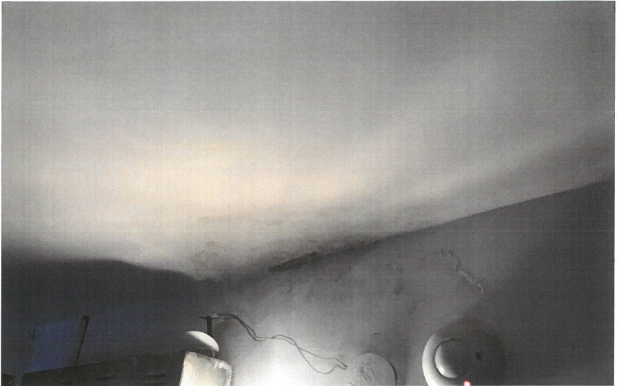
Zaciek na klatce schodowej (pod masztem antenowym)
