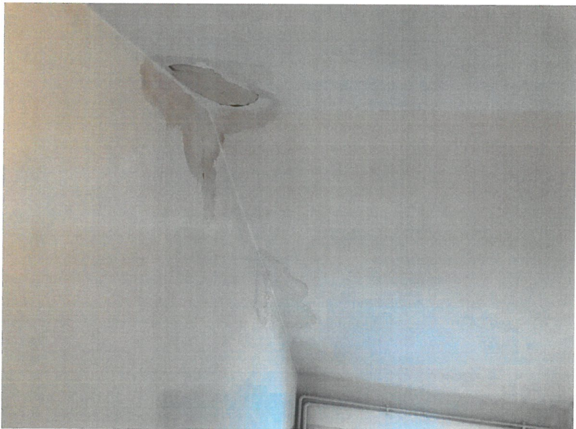
Zaciek na klatce schodowej (przy kominie nr 3)
