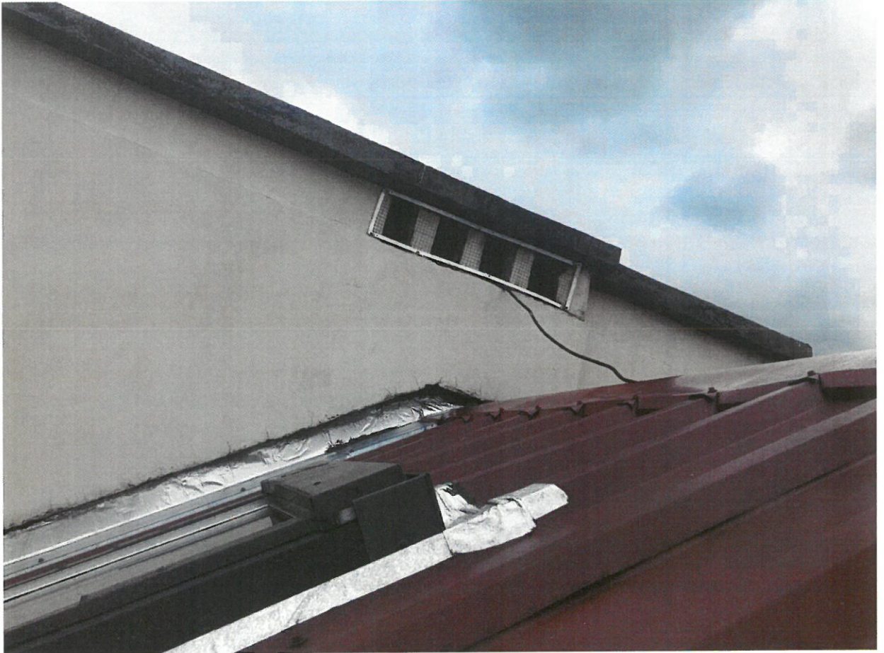
Komin nr 6 i uszczelnienie okna połaciowego w lokalu nr 19
