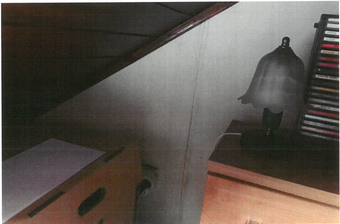
Zaciek w lokalu nr 19 (przy kominie nr 6)
